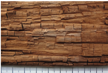
Bild 4.2 Braunfäule mit kleinem Würfelbruch
